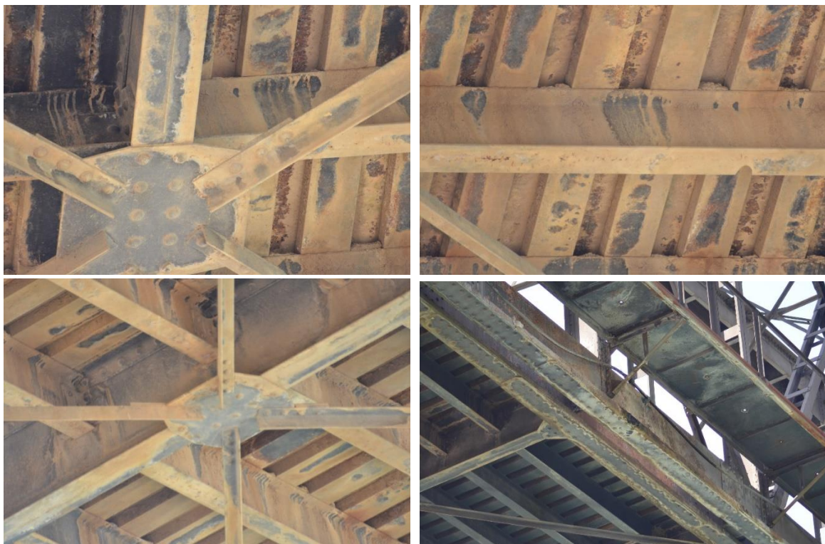
Figura 6 Ekspozimi i çelikut dhe korrodimi i tij, Probleme të durabilitetit
