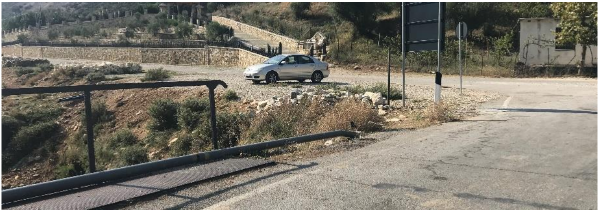
Figura 11 Dëmtime në Trotuarë, prishja e funksionit pasi janë vendosur tubacione
