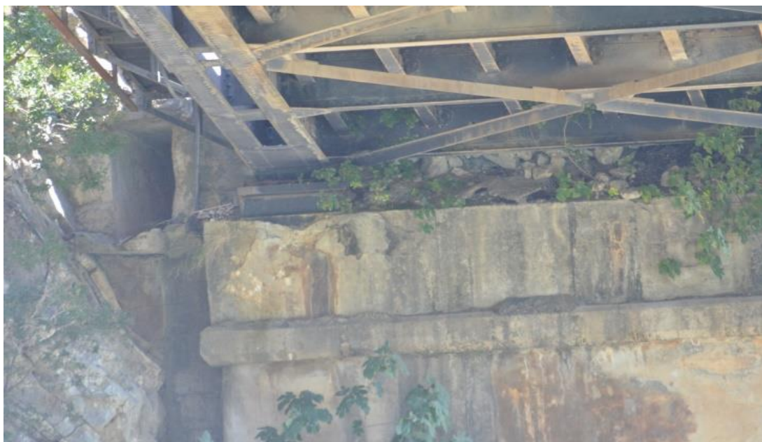
Figura 5 Degradimi i betonit në zonën e çernierave, balli nga Tepelena
