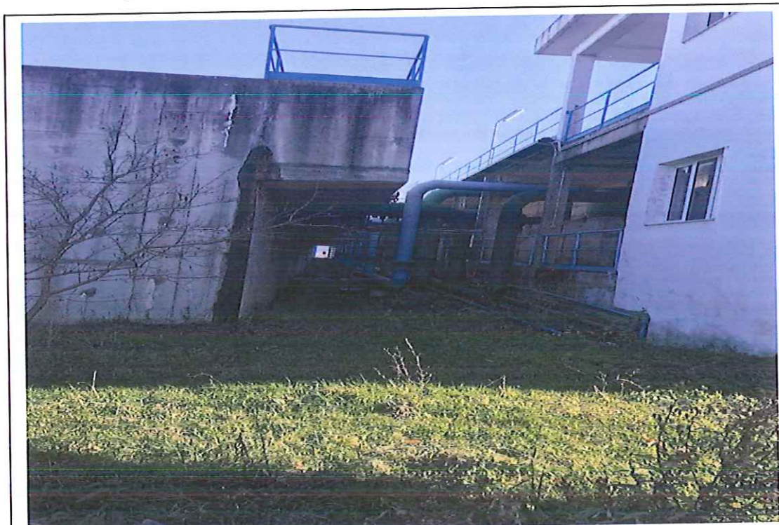
Figure 5, Pamje e tubacioneve teknologjike te filtrave ekzistues
