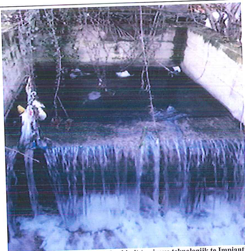
Figure 44, Pamje e pusetes se shkarkimit te ujrave teknologjik te Impiantit
